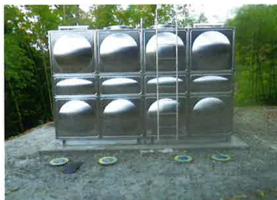
下奈良本第1減圧槽
