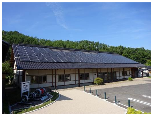
図書館の屋根に設置された太陽光発電設備
