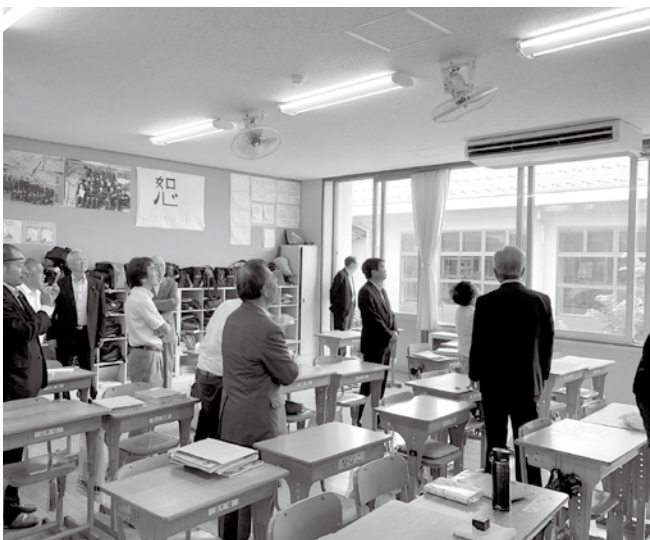
竣工した中学校教室の空調設備
