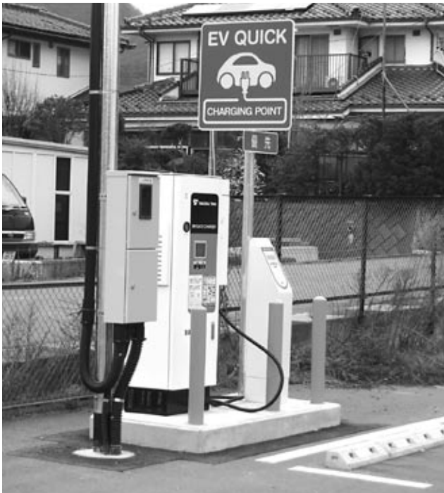
コンビニエンスストアに設置された電気自動車用の充電スタンド
