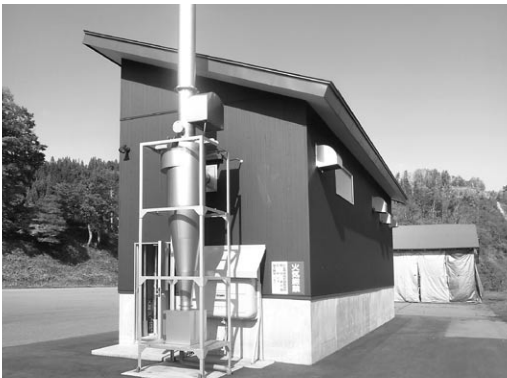
栄村の循環型森林エネルギーボイラー設備
