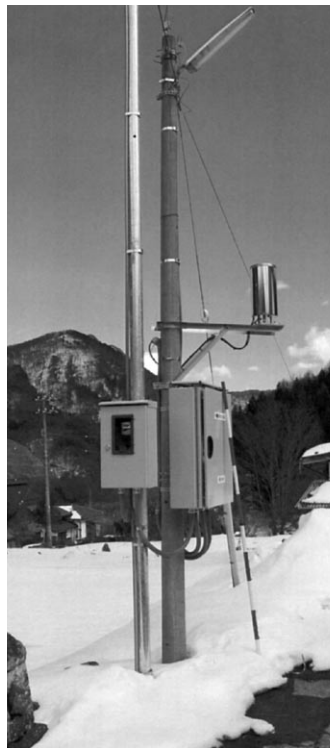
雨量監視システム
