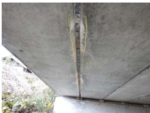
健全度 III : 夫神橋
