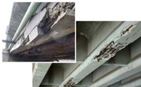
健全度 IV : 長野県点検要領より
